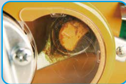
グリースの劣化
